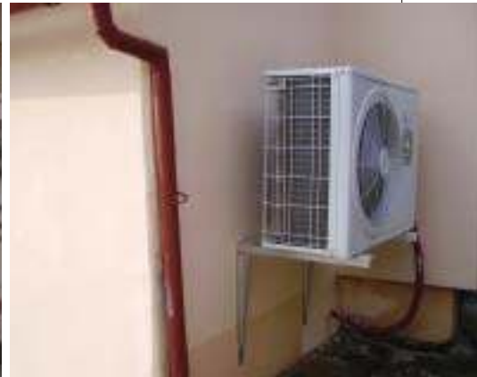
Venkovní jednotka tepelného čerpadla
