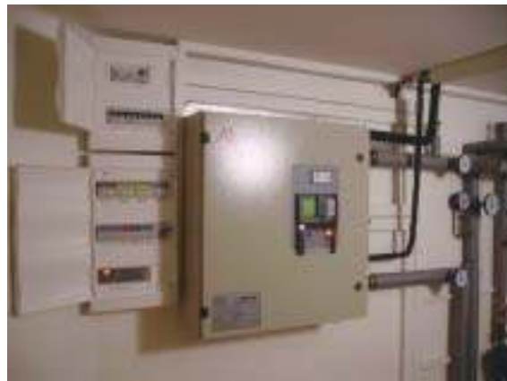
Vnitřní jednotka tepelného čerpadla s rozvaděčem
