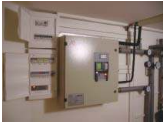
Vnitřní jednotka tepelného čerpadla s rozvaděčem
