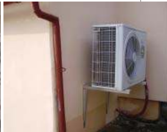
Venkovní jednotka tepelného čerpadla
